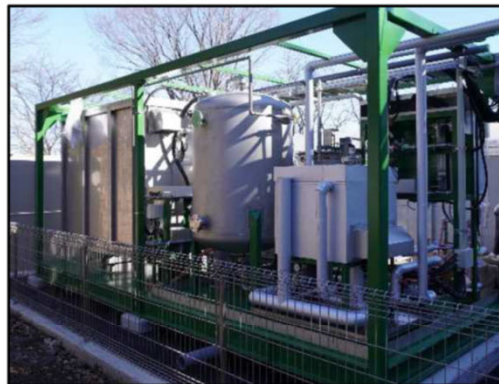
メタン発酵バイオガス発電設備
